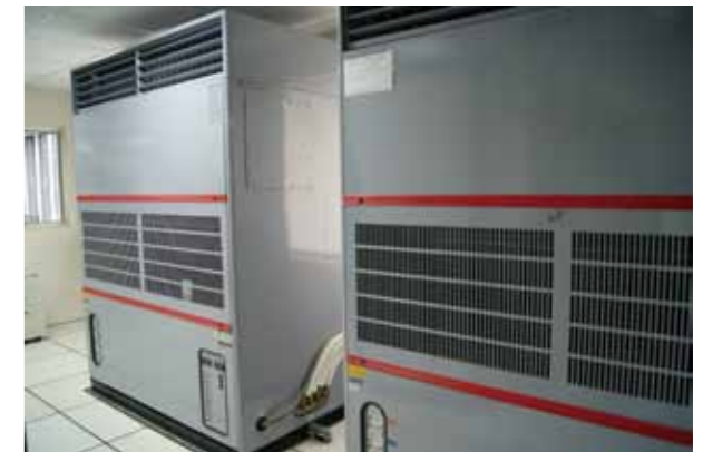
機房內有兩台冷氣，以每4小時輪替使用。
