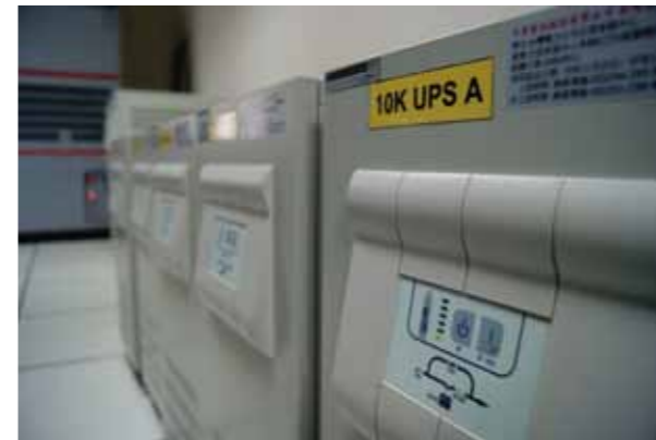
UPS（不斷電系統）電源供應器，停電時，可供給一小時的電力。
