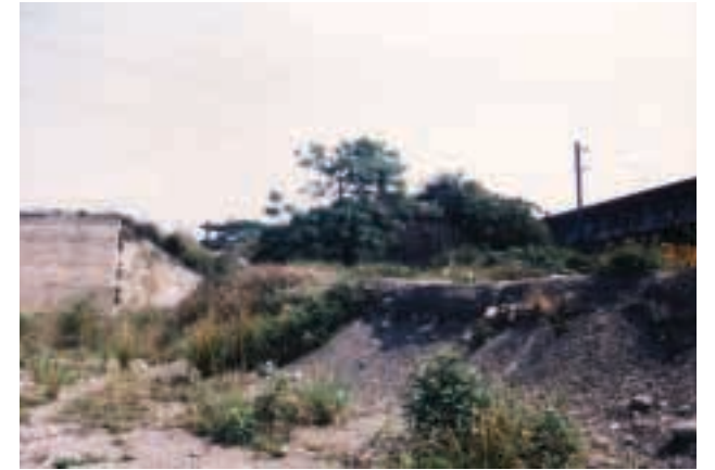
▲堤岸邊的橋墩猶在，但已荒廢在蔓草中
