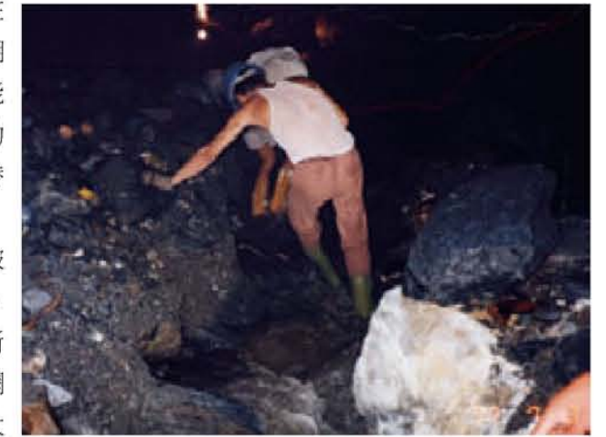
通水隧道內堆滿大小落石只能人工清除。
